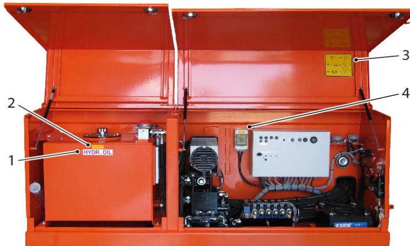
Compartiment d'huile hydraulique et compartiment des soupapes/électricité
